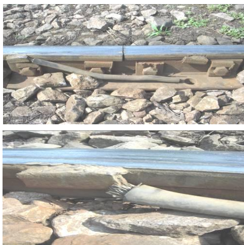
Fig. 9. Broken joints - sector / loop „Pod CFR”
